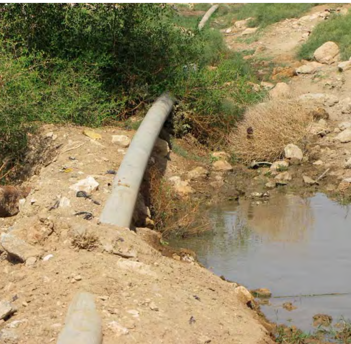
Defekte Wasserleitung am Straßenrand. Ortseingang von Jiftlik im Jordantal.
