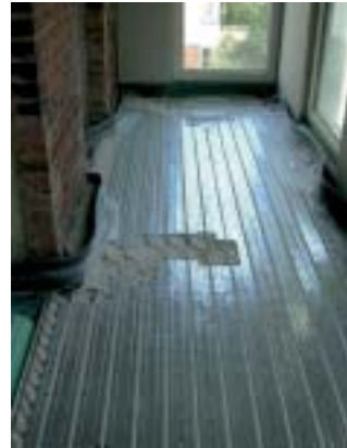
NACHERWÄRMUNGSFLÄCHEN IM FUSSBODEN SORGEN FÜR DEN NACHERWÄRMUNGSBEDARF IN „GESUNDEN KOMFORTHÄUSERN“ UNDERFLOOR BACKUP HEATING IN 'HEALTHY AND COMFORTABLE HOUSES'
