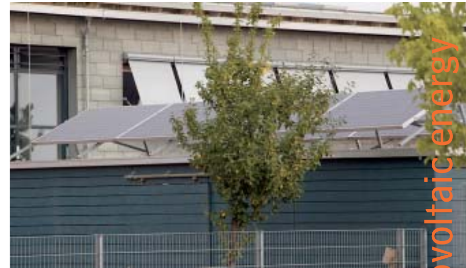
PV-ANLAGE DER GRUNDSCHULE | PV AT KRONSBERG PRIMARY SCHOOL
