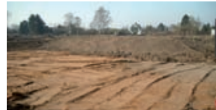
Vorbereitende Tätigkeiten in einem größeren Baugebiet. Der humose Oberboden wurde abgegraben und in trapezförmigen Mieten zwischengelagert.
