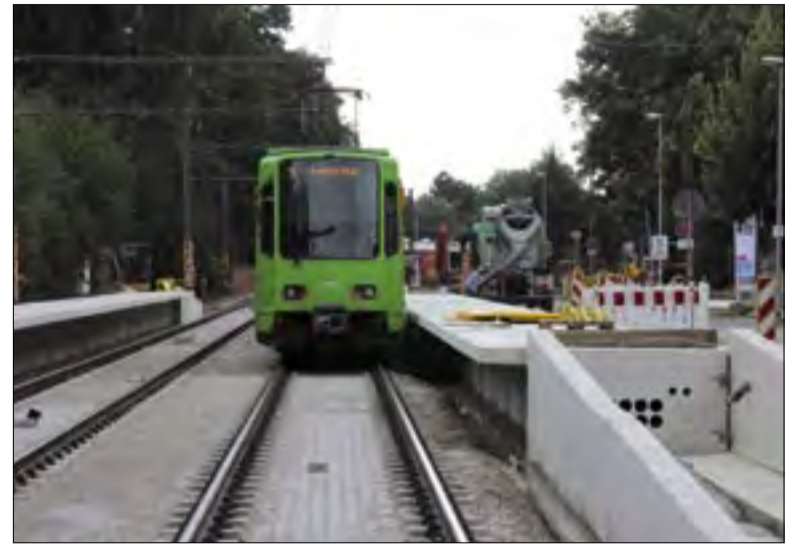
Bis zu zehn Tonnen wiegen die Fertigteile der Hochbahnsteige, die im August montiert wurden. Der Stadtbahnverkehr war während dieser Bauphase nicht beeinträchtigt.
