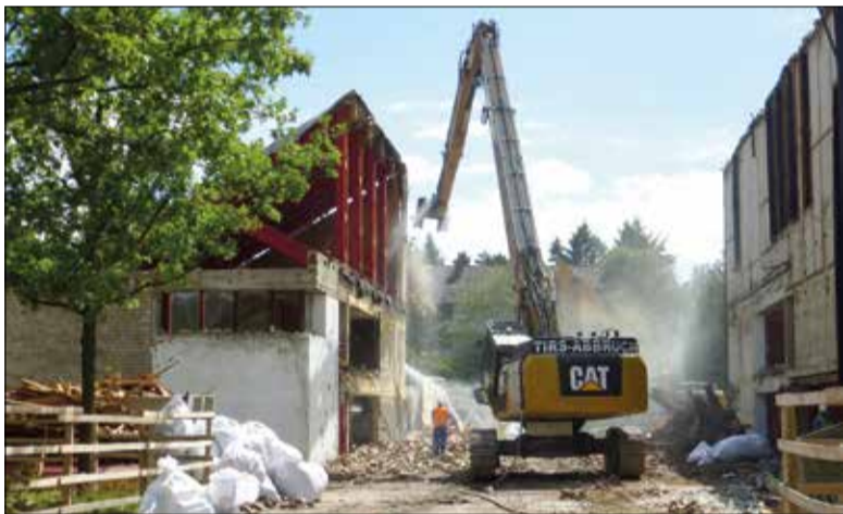
Schweres Gerät musste aufgeföhren werden, um das alte Freizeitheim abzureißen. Die Arbeiten kamen gut voran und wurden im September abgeschlossen.
