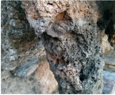
Verwitterung der Steine der „großen Kaskade“ in den Herrenhäuser Gärten von Hannover, Aufnahme Kläß
